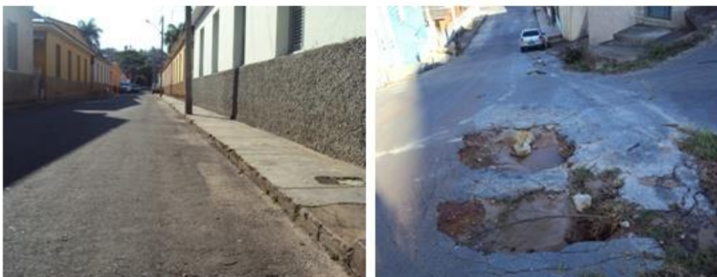
Figura 10 e 11 - Ausência de sarjeta e boca-de-lobo em ruas de São João Del-Rei.
