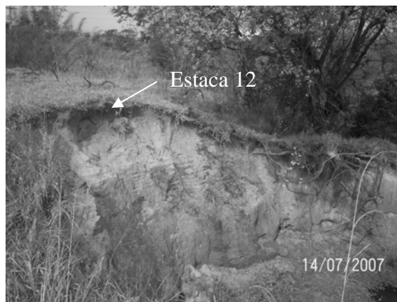
Foto 02. Solapamento de talude por meandro do escoamento de subsuperfície.
