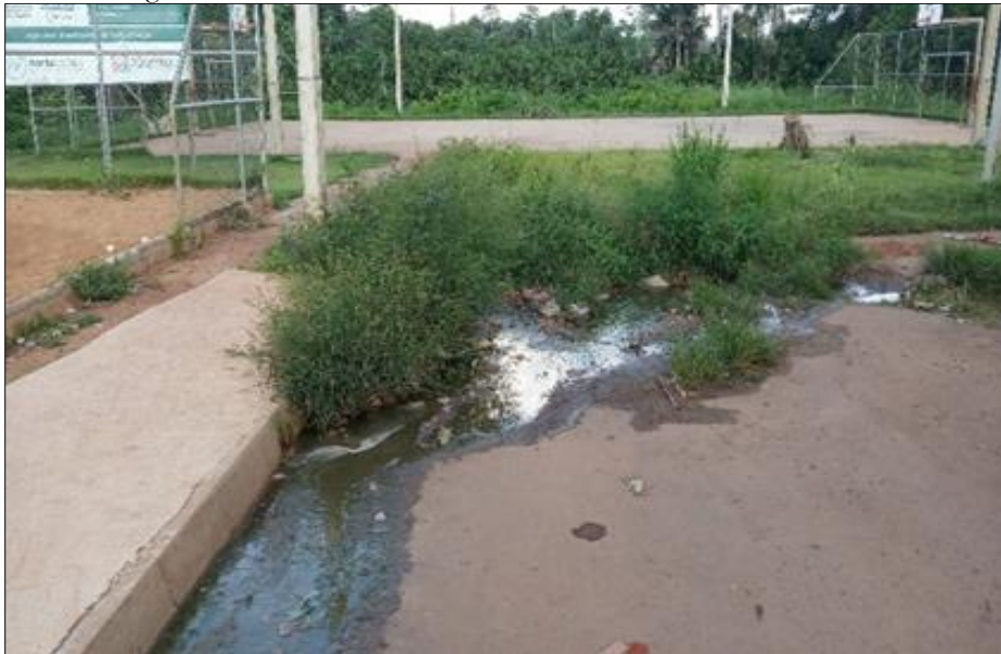
Figura 1: Transbordamento de efluentes na EEE do RUC casa Nova
