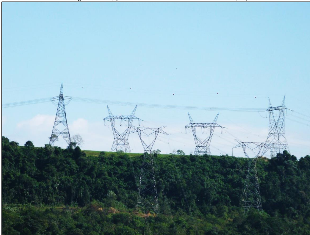
Figura 3 - A alteração da paisagem e consequente inserção de objetos técnicos é um elemento representativo da modernização urbano-industrial sobre áreas consideradas naturais: na figura, estruturas para a transmissão de energia elétrica, produzida na usina hidrelétrica de Itá (SC).
