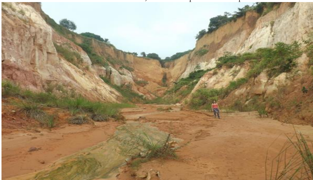
Figura 02: Vista interior de voçoroca e de material sendo carregado para o açude Vila Nova, no bairro Santos Dumont, sede municipal de Buriticupu.
