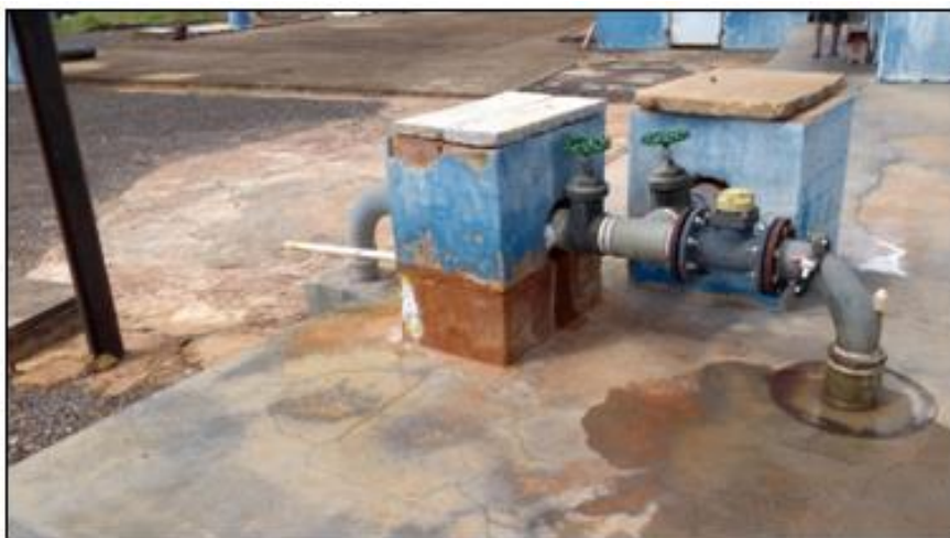
Figura 6. Pacaembu - SP. Poço central, situado no Departamento de Água e de Esgoto (DAE). 2019.
