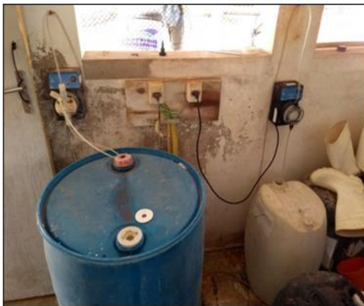
Figura 9. Pacaembu - SP. Equipamentos de cloração (à esquerda) e de fluoretação (à direita) do Departamento de Água e de Esgoto (DAE). 2019.
