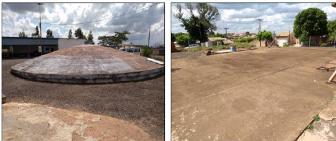
Figuras 7 e 8. Pacaembu - SP. Reservatórios do Departamento de Água e de Esgoto (DAE) utilizados para armazenamento da água coletada, antes de ser tratada. 2019.
