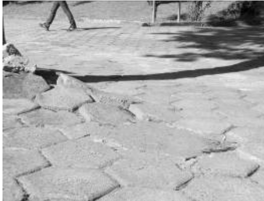
Figura 9: Assentamento irregular do piso sextavado. Fonte: ALMEIDA, P.A.S. (2011)
