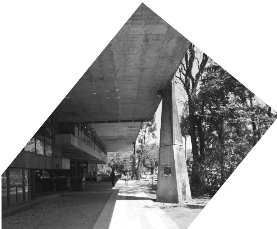
Prédio da FAUUSP em obras de restauração, Cidade Universitária, São Paulo, 2010. Projeto de Vilanova Artigas, foto de Marcos F. Gabriel.
